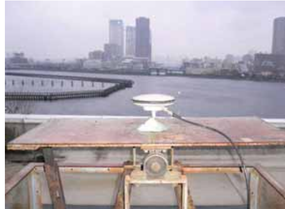
図 4-3 屋上南のアンテナ
